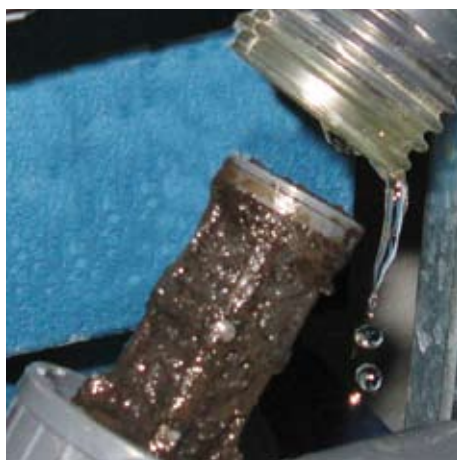
Bild 1: In einer wasserdurchströmten Rohrleitung hat sich ein typischer Biofilm gebildet.
