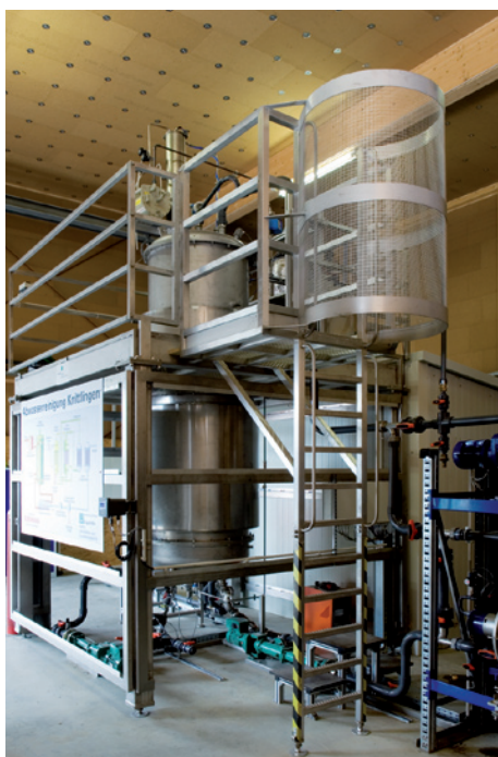
Bild 1: In Knittlingen wird das Abwasser von derzeit etwa 30 Häusern gesammelt und semi-dezentral im Abwasserreaktor gereinigt.
