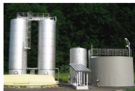
Bild 3: Hochlastfäulung mit Mikrofiltration für eine Kläranlage für 10 000 EW, Inbetriebnahme 2007.
