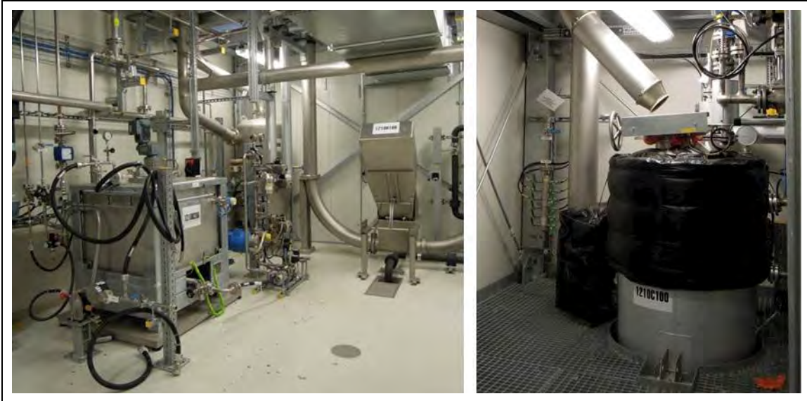
Abb. 71: Teilanlage 1210 Holzaufschluss. Links: atmosphärischer Vorlagetank B200 mit Hochdruckpumpe sowie Holzaufgabe Rohrkettenförderer. Rechts: Aufschlussreaktor C100. (Quelle: CBP)
