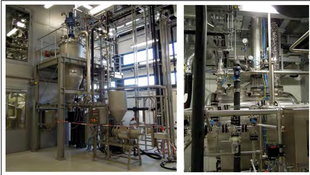
Abb. 74: Links: TA 1240 Cellulosewäsche und -entwässerung mit Waschbehälter und Schneckenpresse. Rechts: TA 1250 Lösemittelrückgewinnung mit Destillationssumpf, Verdampfer und unterem Kolonnenteil (Quelle: CBP)
