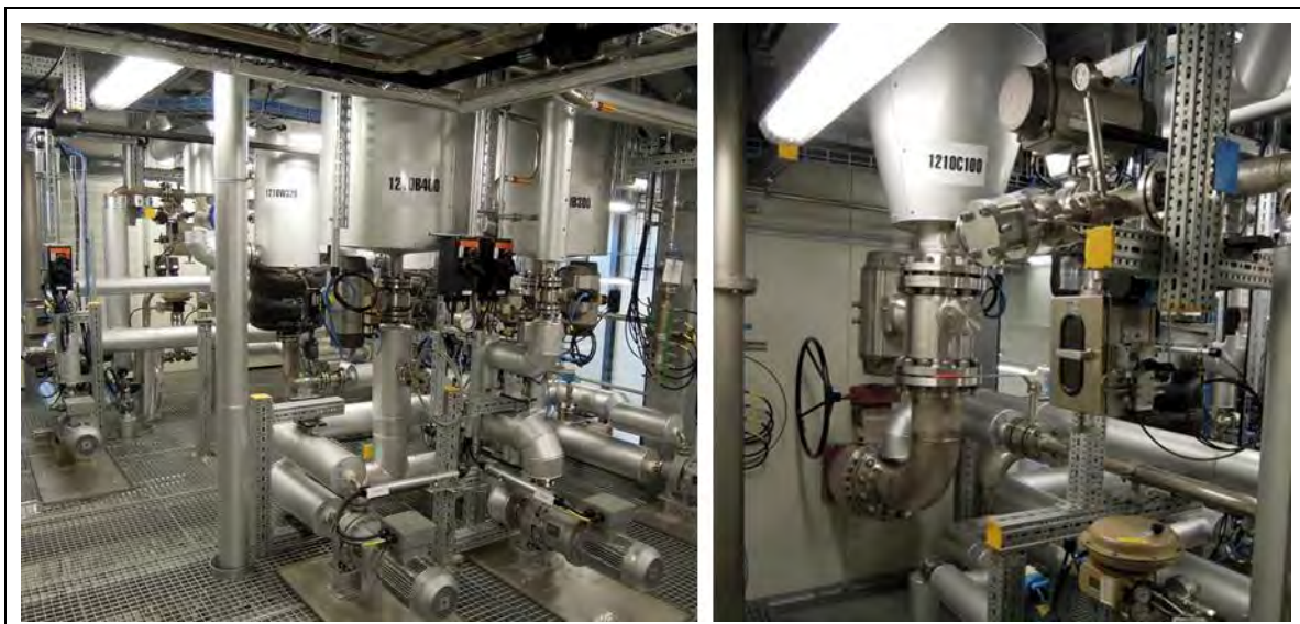
Abb. 72: TA 1210 Holzaufschluss. Links: Druckvorlagebehälter B400 und B300 mit Umwälzpumpen und Rohrbündelwärmetauscher. Rechts: Laugenzirkulationsleitung mit Probenahme sowie Bodenventile des Aufschlussreaktors C100, Blasleitung für die Entleerung der Cellulosefraktion in die TA 1240 (Quelle: CBP)
