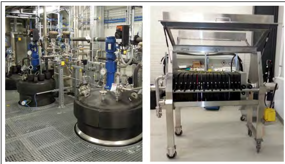
Abb. 73: Links: TA 1220 Ligninfällung mit den Fälltanks B200 und B100. Rechts: TA 1230 Ligninfiltration (Quelle: CBP)
